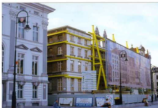
Gent. Intervento di riuso di un complesso edilizio con recupero della cortina esterna.
